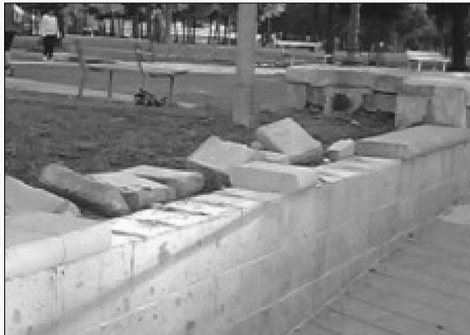
I mattoni divelti dal muretto realizzato da pochi mesi
